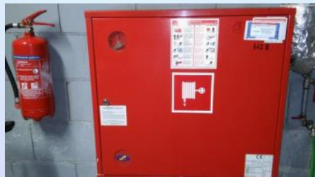
HYDRANTY WEWNĘTRZNE WĘŻE HYDRANTOWE ZBIORNIKI WODY HYDRANTOWEJ
